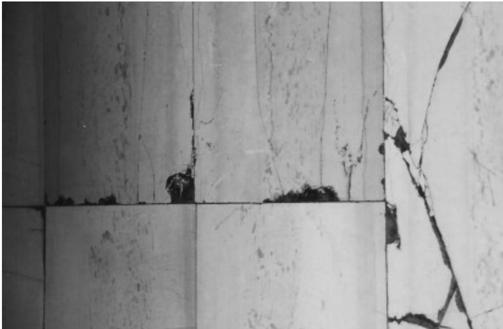
Δαπεδόστρωση με ασβεστολιθικές πλάκες. Αποφλοιώσεις στους αρμούς.
