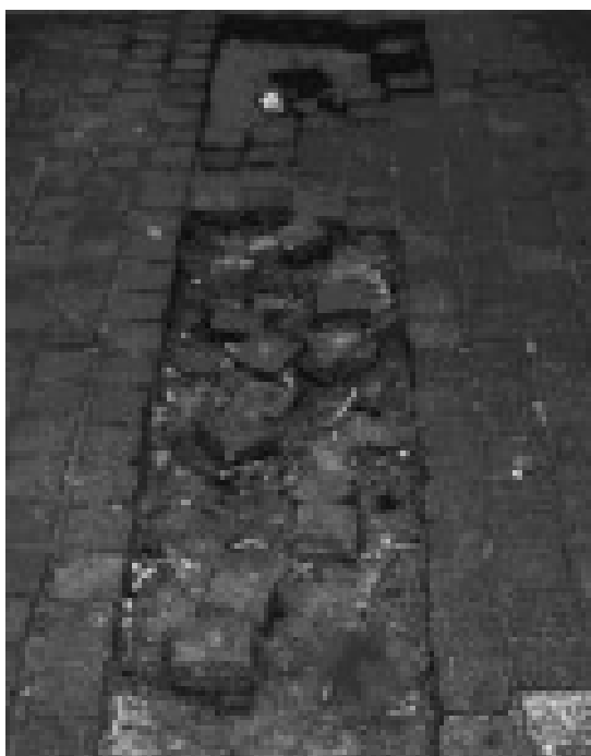
Μη λειτουργική και κακότεχνη επίστρωση πεζοδρόμου με κυβολίθους.
